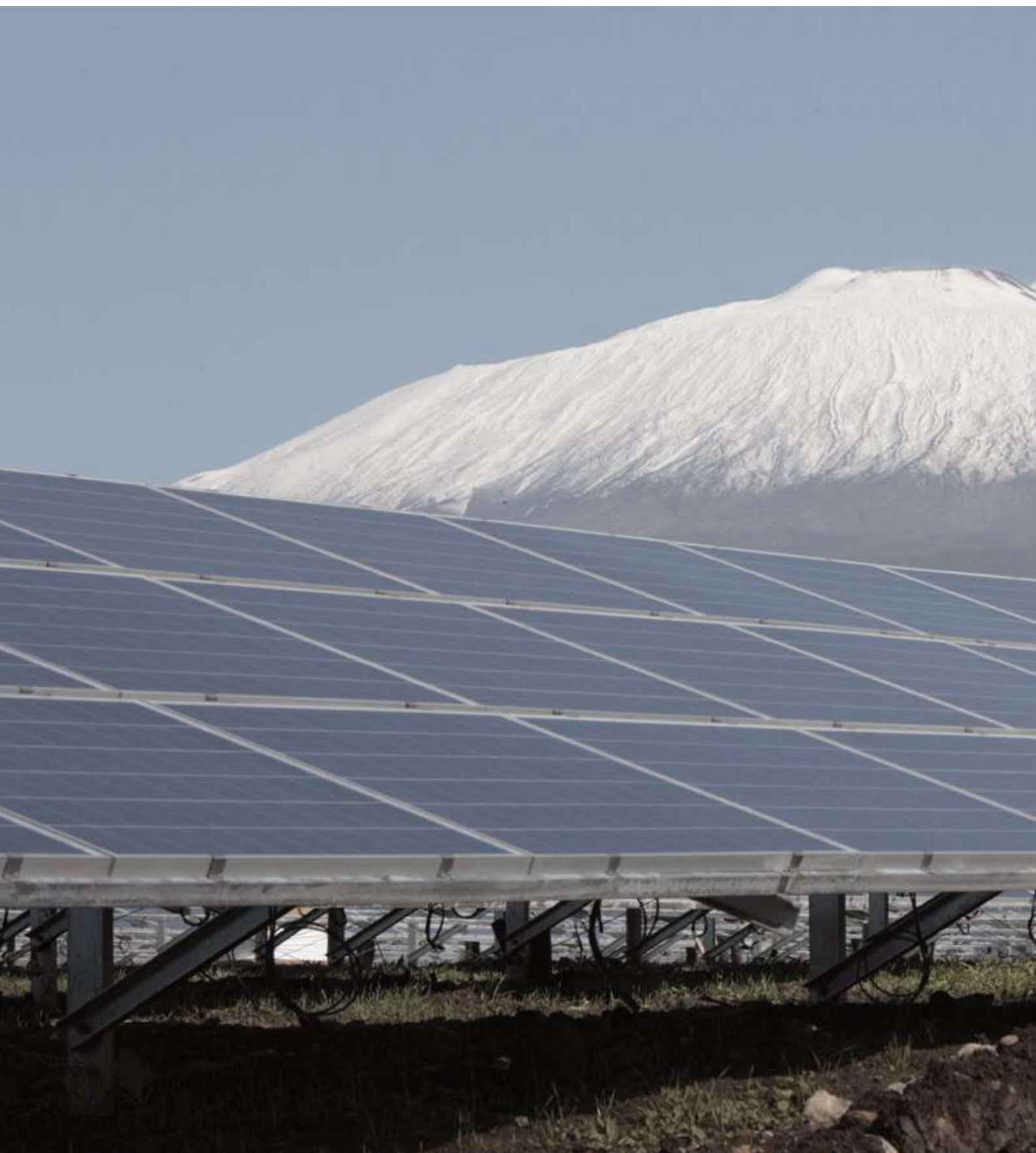
Impianto fotovoltaico di Cardonita-Centuripe (Enna).
